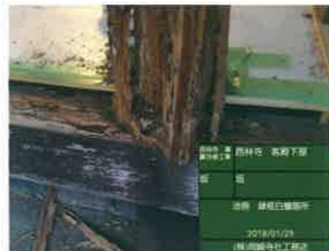
かまちが白蟻で腐食状態
