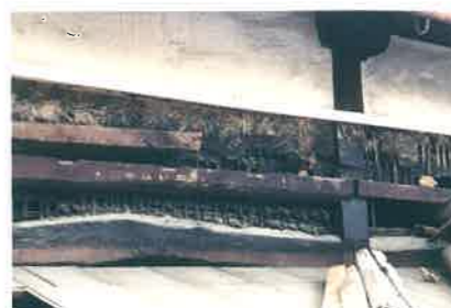
軒下 本堂火災時の延焼部分
